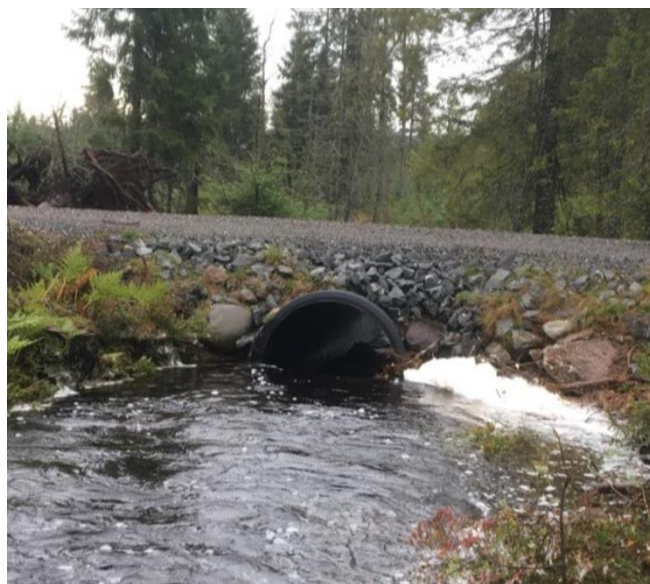
Bilde 8 – Denne stikkrenna er dimensjonert stor nok for å ta unna de store vannmengdene som kom ila. en uke høsten 2017.
