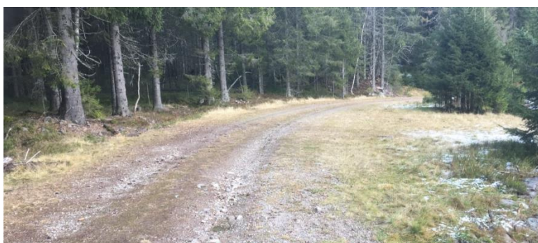
Bilde 2 – En vei, farbar, men med mange feil og mangler. Legg merke til mangelen på grøfter, spor og vannskader og kantvegetasjon inntil veg.
