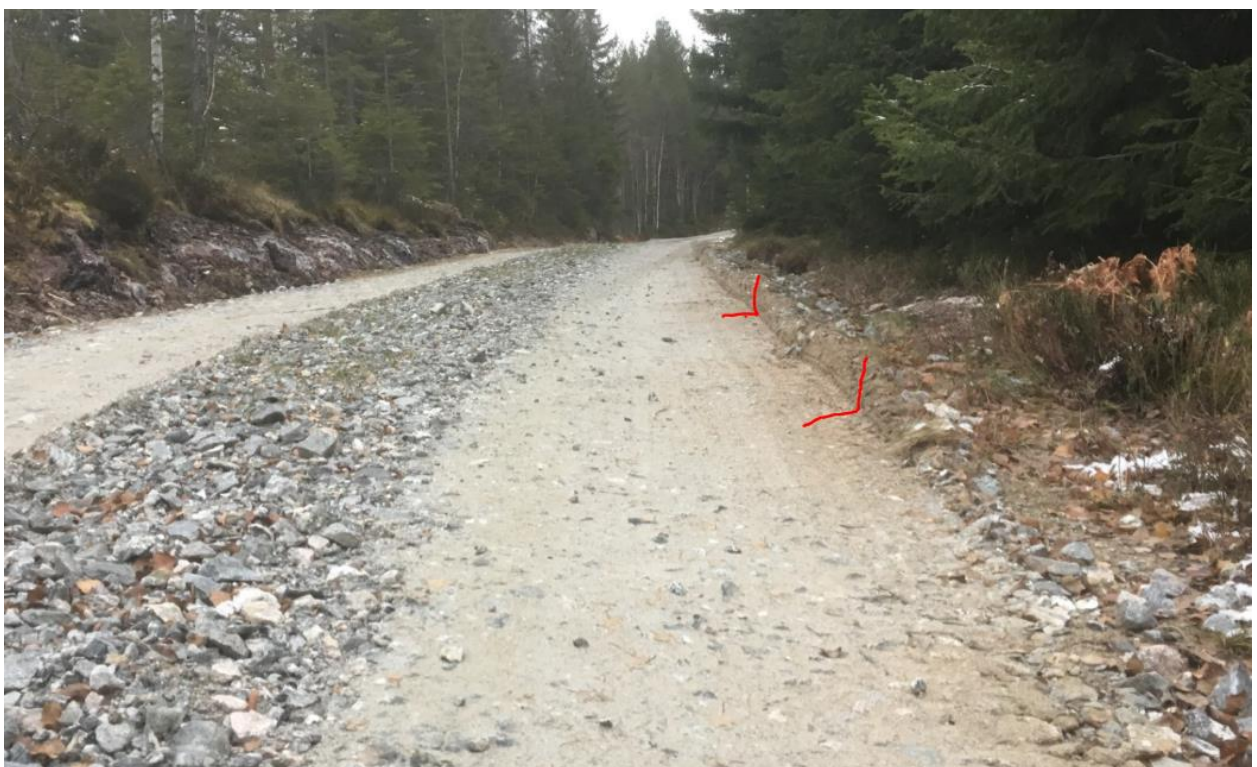
Bilde 3 – Grøvre veivedlikehold med grøfterensk, påkjøring av masser og noe kantrydding var ikke nok for å få en skogsbilvei i Romeriks allmenningene til å tåle tømmertransport i fuktig vær i 2016. Bæreevnen er for dårlig. De røde markeringene på bildet viser spordannelse. Disse sporene vil senere hindre overflatevannet i å renne ned i grøft og kan ved kraftig regnvær føre til store vannskader i veien.
