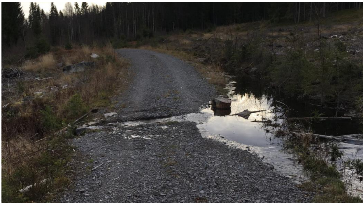
Bilde 4 – Her burde det vært et større rør.
