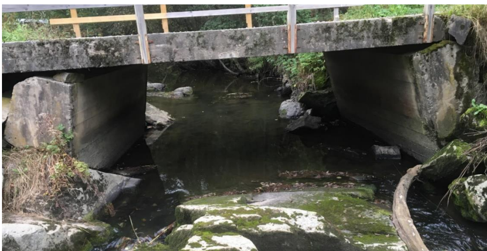
Bilde 6 – En bru der bruelementene sklir fra hverandre. Denne brua må utbedres.
