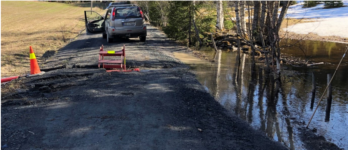
Reparasjoner som skyldes forsømt ettersyn og vedlikehold kan ikke dekkes med skogfond. Det dekkes heller ikke av naturskadeordningen. Foto: Martin Bråthen
