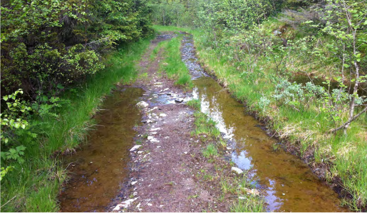
Gjengrodd vei som ikke har blitt vedlikehold
